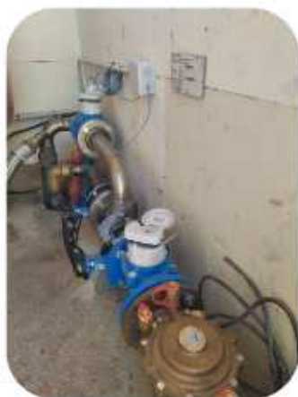
Local pompage - Près Lajus
