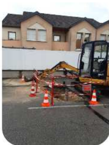
Exemple d'un branchement au 26 rue des Bouleaux
