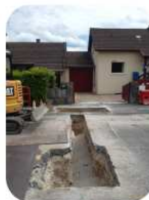
Exemple d'un branchement au 7 rue des Bouleaux
